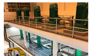
Lusail下水処理場・ポンプ場
