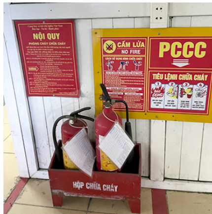
定期点検済みの消火器
