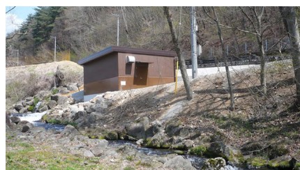
小水力発電所（山梨県北杜市）
